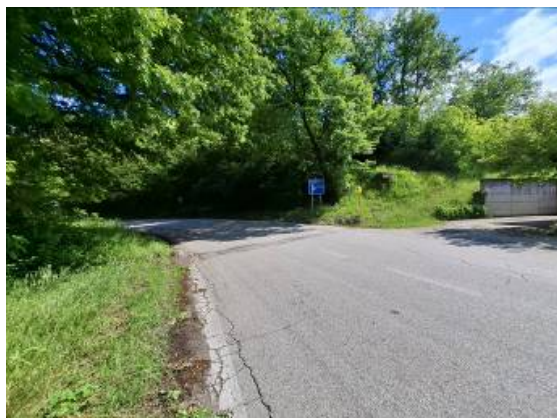
Immagine # 8 – Immagine stato di fatto – Tratto 02/Muro C.A./Attrav. P.01
